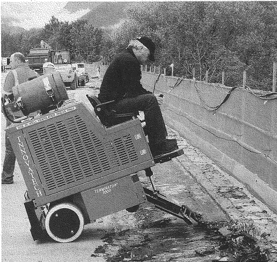
Im besten Fall wird mit dem Terminator die Beschichtung fast ohne Rückstände vom Untergrund entfernt und kann nun separat entsorgt werden. Foto: Contec
